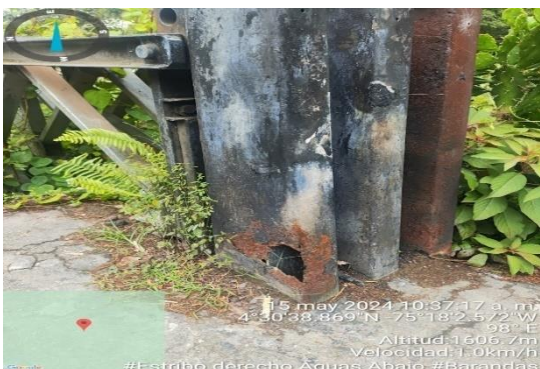
Figura No 15. Corrosión sobre elementos metálicos
