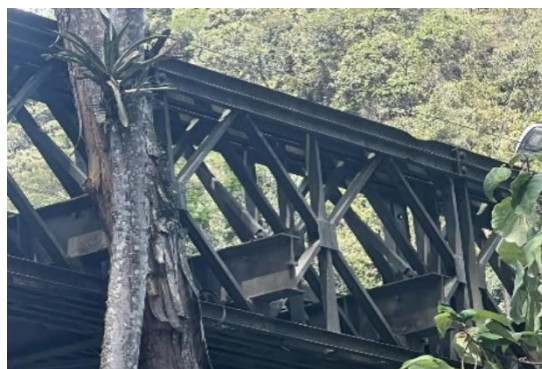
Figura No 16. Deformación local de elemento metálico
