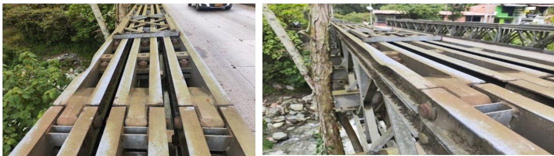
Figuras No. 9 y 10. Aspecto del cordón superior
