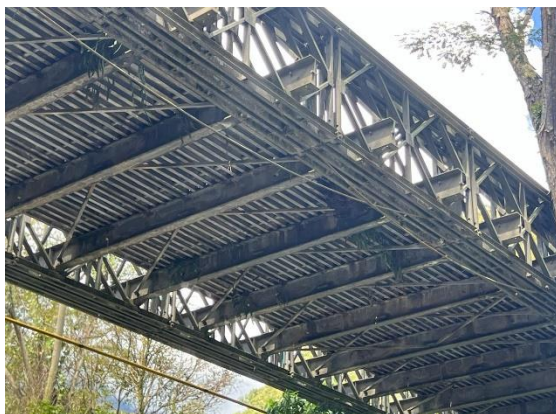
Figura No 13. Vegetación sobre los elementos tipo riostras y diagonales Edificio Gobernación del Tolima - Carrera 3 entre calle 10 y 11
